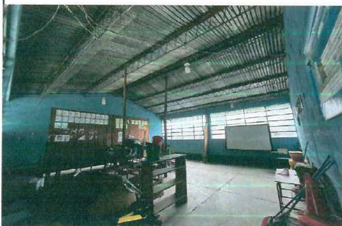
Foto1: REPARACION DE ESTRUCTURA DE TECHO EN MAL ESTADO
